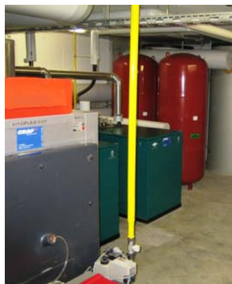
Energiezentrale im DEMAX-Demonstrationsobjekt. Quelle: Fraunhofer ISE
